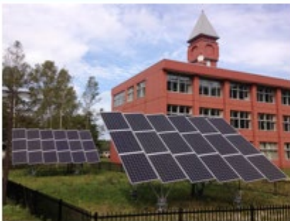
避難所に設置した太陽光発電
